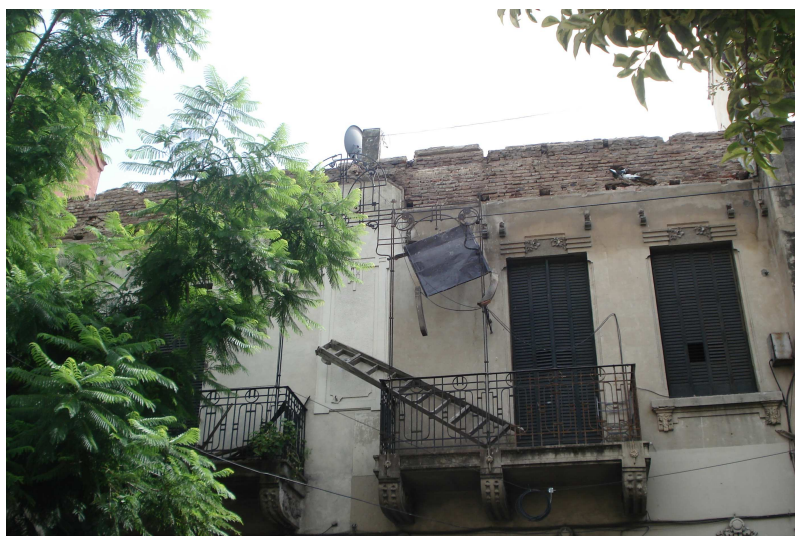
Edificio patrimonial con demoliciones sin permiso
